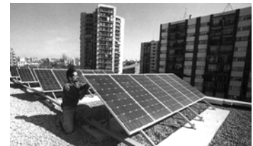
Plaques fotovoltaïques, ancorades sobre lloses de formigó sobreposades a la coberta
