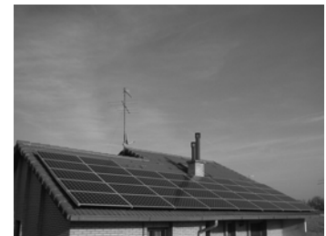
Instal·lació solar fotovoltaïca autònoma
