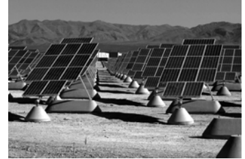
Central elèctrica fotovoltaica, que transforma directament la radiació solar en electricitat.
