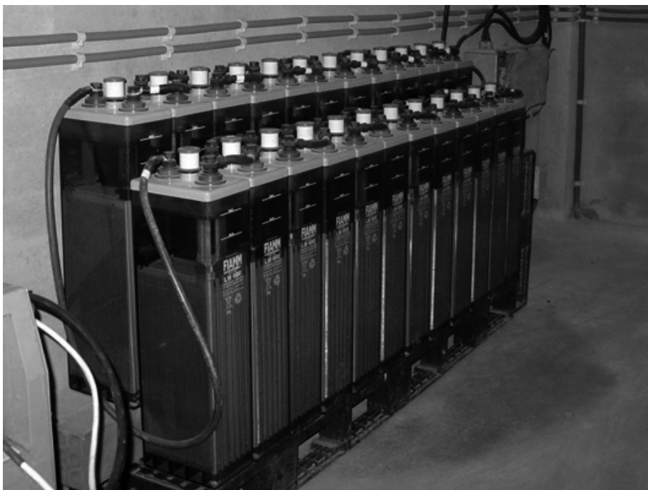
Figura 26. Bateria estacionària de gran capacitat per a una instal·lació solar
