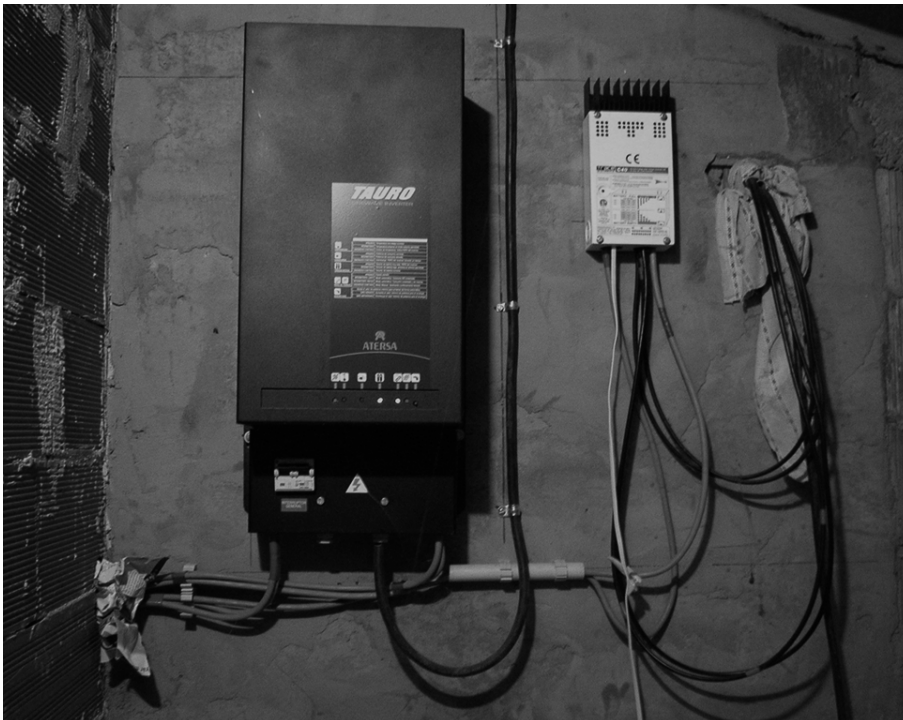
Figura 4. Instal·lació precària d'un convertidor i l'equip regulador de carregacàrrega
