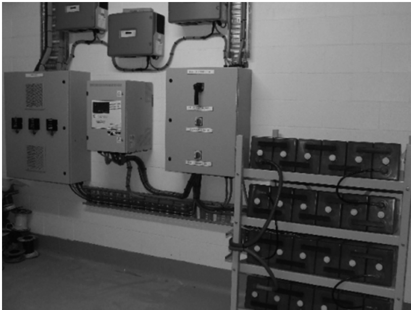
Figura 3. Sala amb bateries estanques de plom àcid
