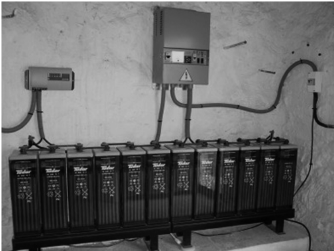
Figura 5. Instal·lació inadequada del regulador i l'inversor en una instal·lació fotovoltaïca autònoma
