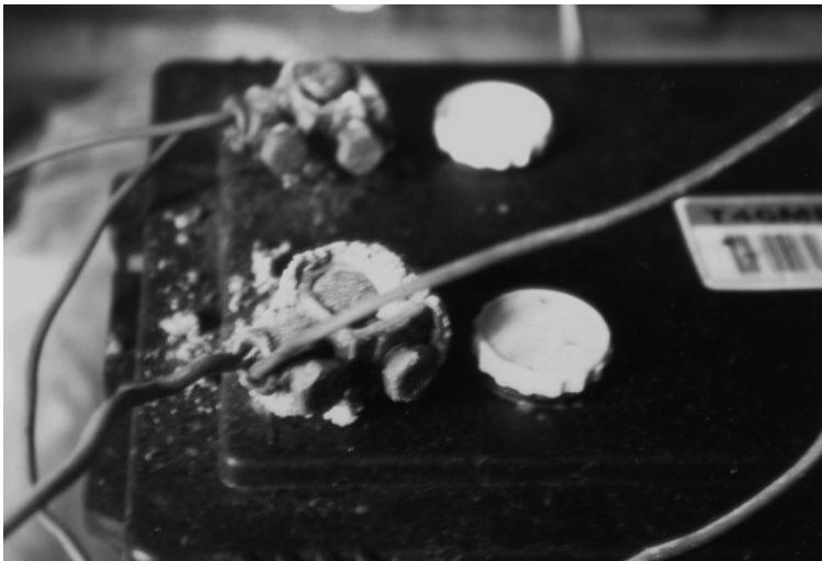
Figura 11. Bateria amb els terminals oxidats
