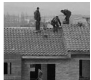
Operaris treballen en una coberta sense cap tipus d'element de protecció.
